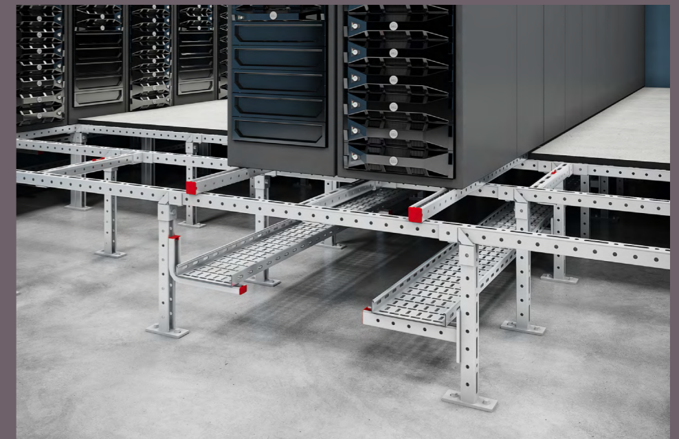
Полное оснащение фальшпола
